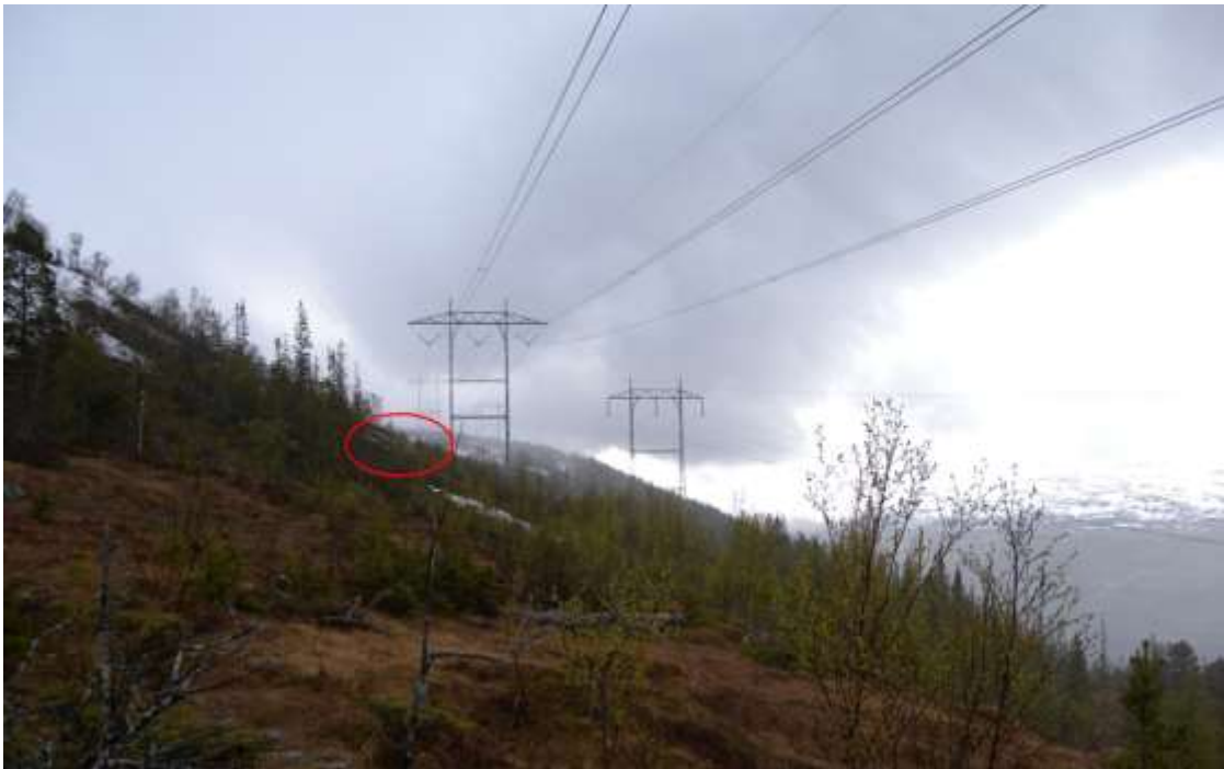
Figur 4: Terrengtet rundt havaristedet sett mot sør fra mast 147. Havaristedet er markert med rød sirkel ved foten til mast 148. Foto: SHT
