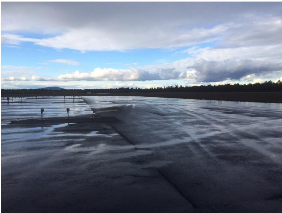
Figur 3: RESA. Asfaltert område utenfor rullebaneenden. Bildet er tatt kort tid etter hendelsen. Hjulspor etter SAS4425 er synlig på bakken. En knekt lysarmatur er også synlig. Foto: Plasttjenesten Oslo Lufthavn AS
