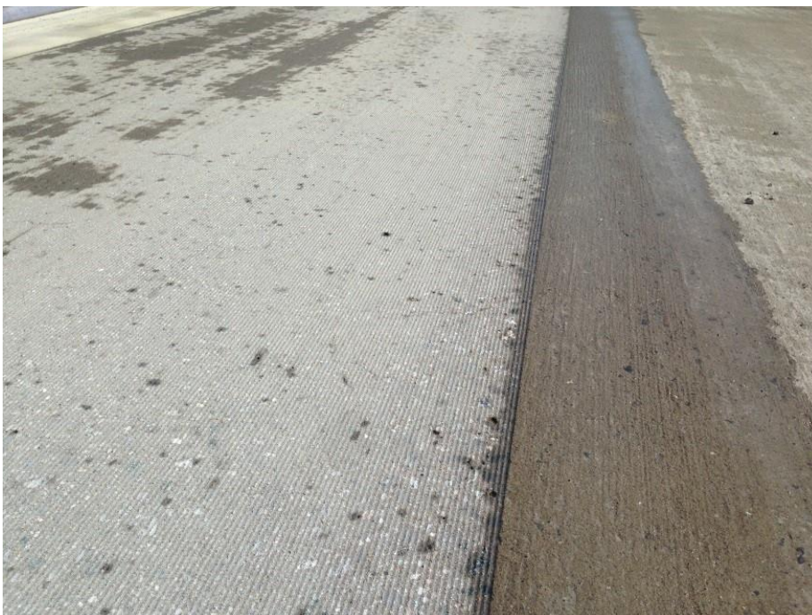
Figur 8: De fire betongflatene på Oslo lufthavn ble frest i etterkant av hendelsen (august 2015). Bildet viser forskjellen mellom frest og ikke frest betong. Foto: Plasstjenesten, Oslo Lufthavn AS
