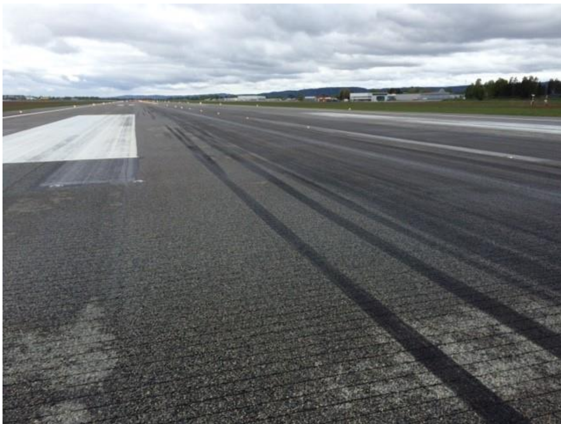
Figur 6: Før sweeping av gummi 26. mai 2015. Bildet viser hvordan asfalten er rillet (grooved). Foto: Plasstjenesten, Oslo Lufthavn AS
