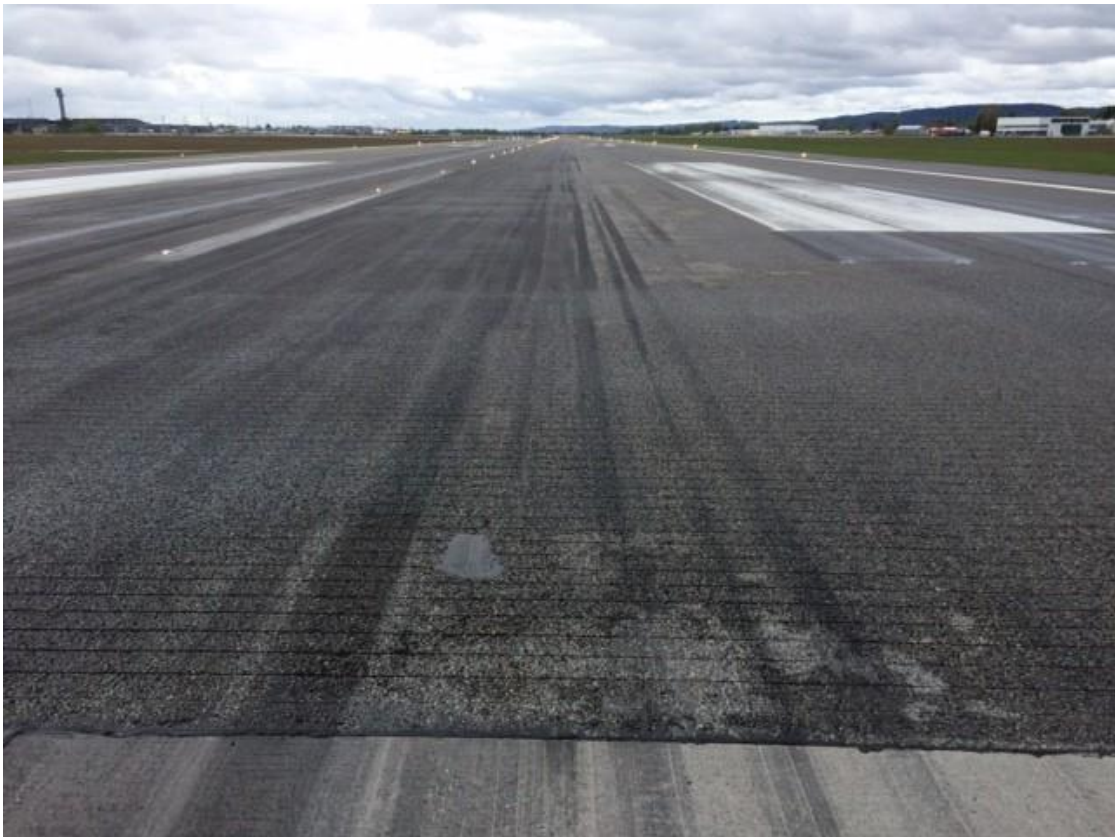
Figur 7: Før sweeping av gummi 26. mai 2015. Overgang mellom asfalt og betong. Foto: Plasstjenesten, Oslo Lufthavn AS
