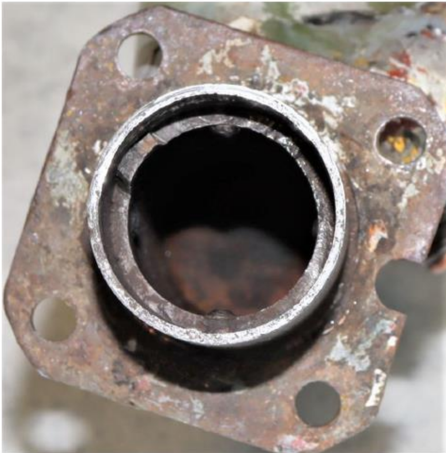
Figur 3 Oversiktsbilde av bruddskaden etter vasking med Alconox og teknisk sprit.
