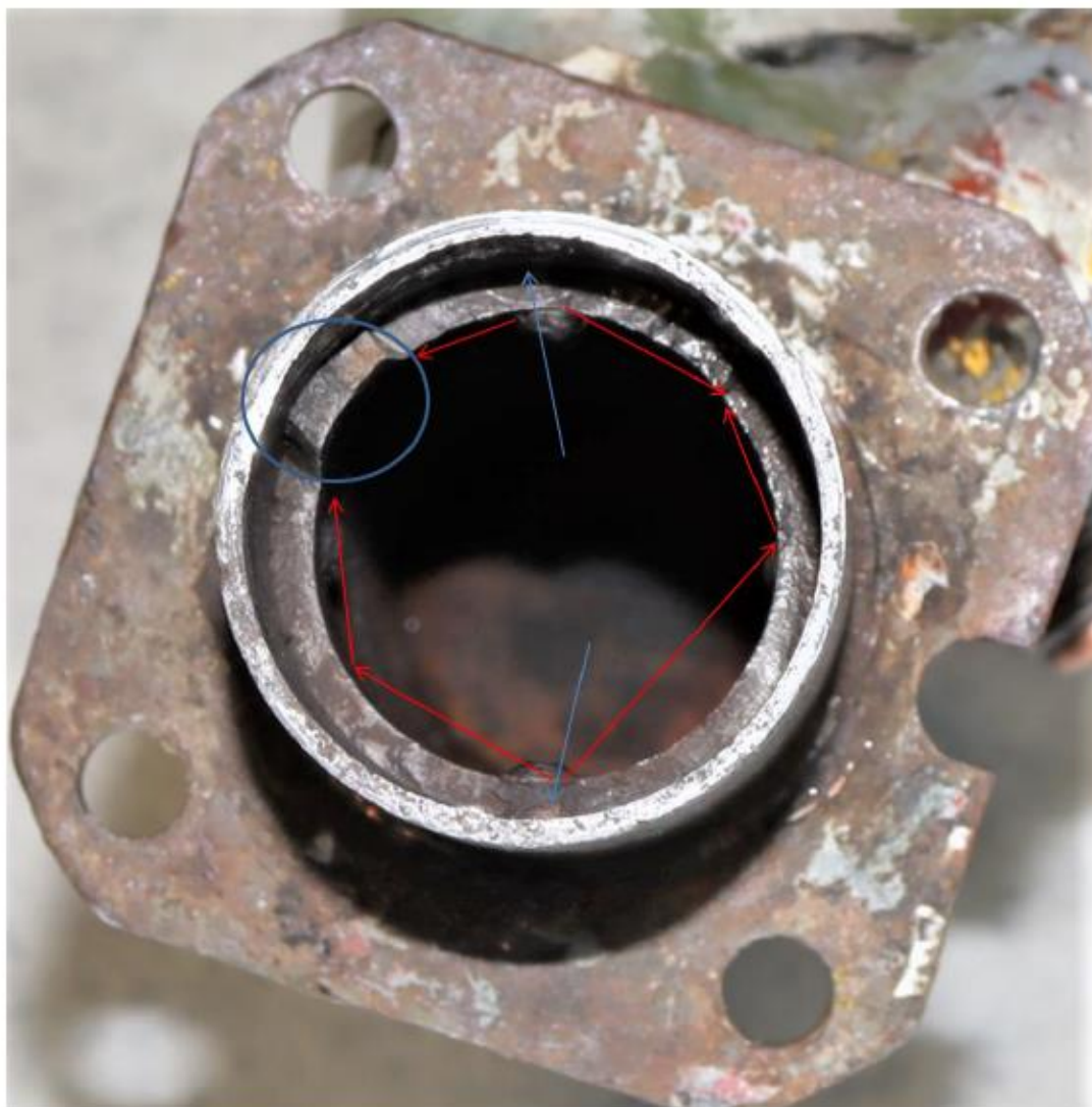
Figur 7 Oversiktsbilde av bruddskade med angivelse av observasjoner kommentert i Figur 4 til Figur 6. Røde piler angir sannsynlig retning til sprekkforplantningen. Blå piler angir mulige initieringspunkter knyttet til punktsveiser. Blå sirkel angir område med mulig restbrudd.
