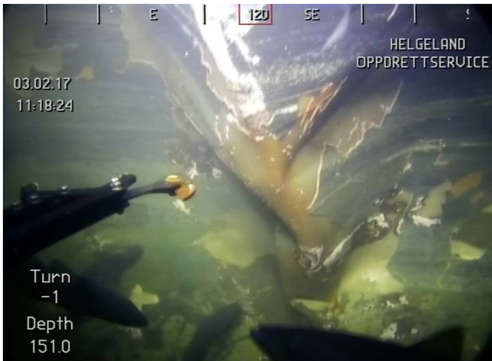
Figur 6: Bildet viser skader i skrog, et stykke ned på skutesiden i akterskipet. Kilde: TMC Marine
