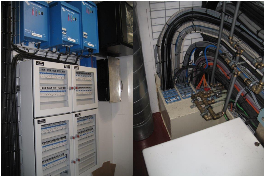
Figur 7: Høyre bilde viser kabelgater i teknisk rom med gjennomføringer. Venstre bilde viser el-tavler inkludert nødtafle og Scanmar pc (til høyre i bildet). Foto: Kynde & Toft
