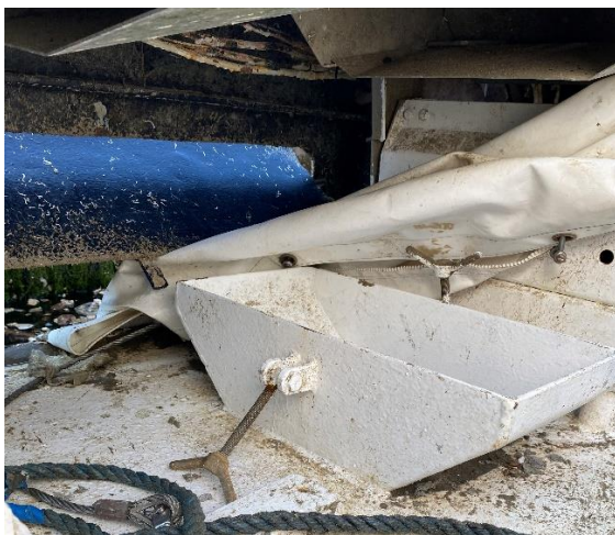
Figur 7: Luka var plassert rett innenfor en lenseport på styrbord side. I høyre hjørne er renna/trakten ned fra sollemaskinen og rett ned i luka. Foto: Sjøfartsdirektoratet
