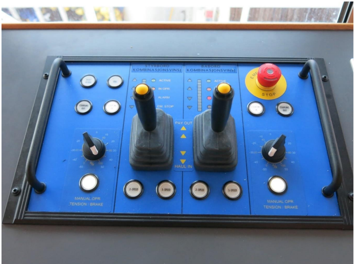
Figur 8. Kontrollpanel i styrhuset ved akter posisjon for operasjon av styrbord og babord trålvinsj på framdekket. (Sjå òg figur 5.) Foto: SHK
