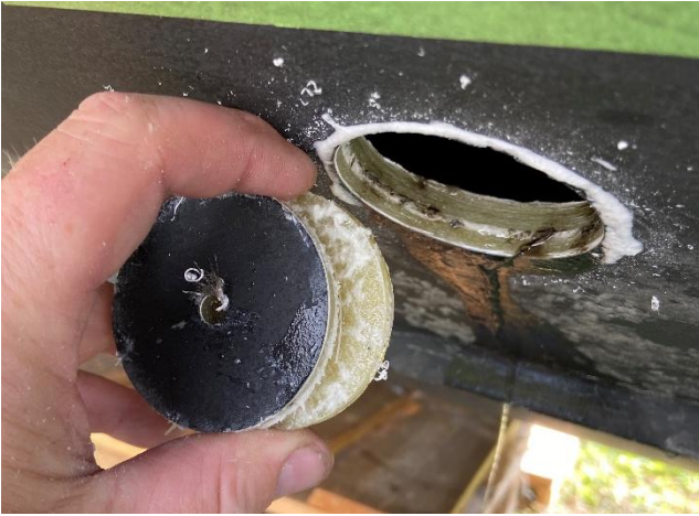
Figur 17: Kjerneborprøver viser at det er delaminering mellom laminatene samt at det er glassfiberstøv mellom laminatlagene. Prøve 2 på styrbord side. Foto: Konsulenten
