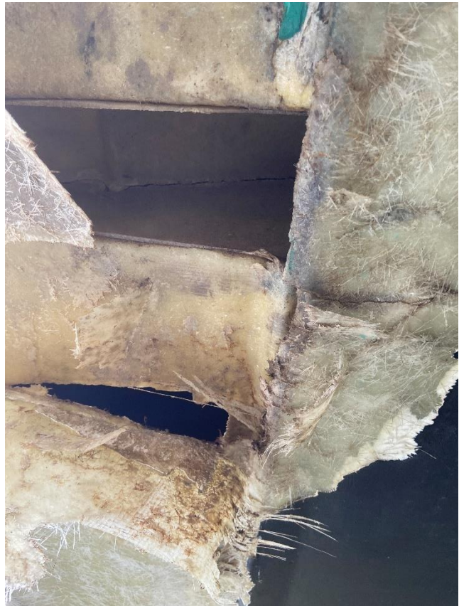
Figur 16: Skroglaminatet har løsnet og det er hull rett inn i båten. Foto: Konsulenten
