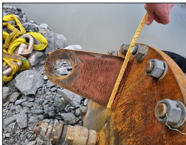
Figur 28: Blindflens med stengeventil og slepeøye. Foto: Vassbakk og Stol AS
