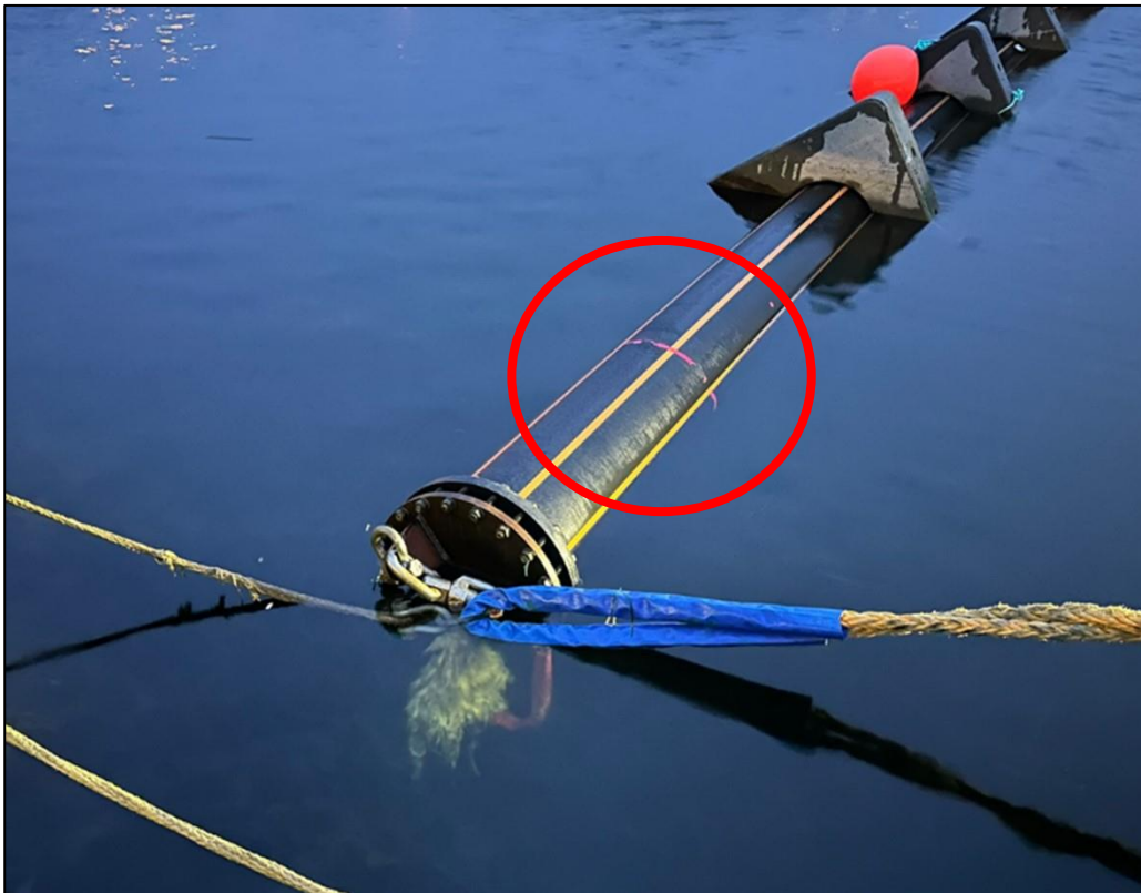
Figur 19: Den røde ringen på røret indikerer hvor betongloddet som manglet var plassert. Foto: SHK
