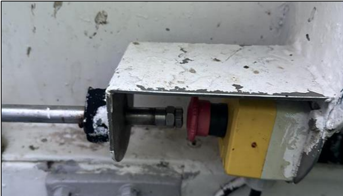
Figur 6: Nødstopp tilkoblet staget ved arbeidsposisjonen. Foto: SHK
