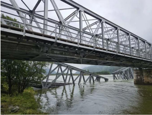
Figur 24: Flommen etter «Hans» ødela fundamentet til Randklev bru, Dovrebanen. Foto: Bane NOR SF
