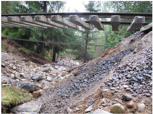
Figur 22: Sporet hvor underbygningen hadde blitt vasket ut før ulykken ved Opphus i 2011. Foto: SHK
