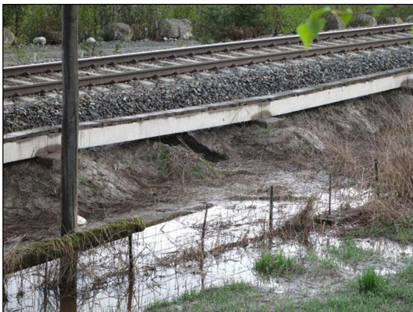
Figur 7: Tilstanden ved km. 281,507. Foto: Jernbaneverket
