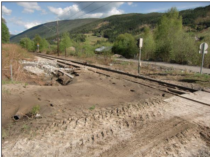
Figur 6: Flomskadene ved km 281,470. Foto: Jernbaneverket
