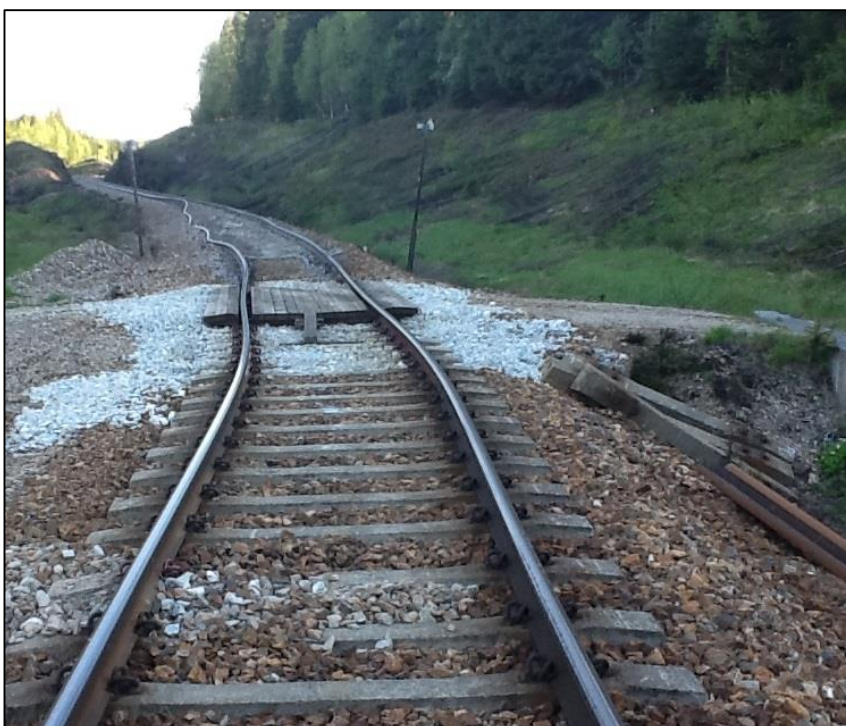
Figur 3: Avspøringsstedet og det ødelagte sporet etter avsporingen. Foto: Jernbaneverket
