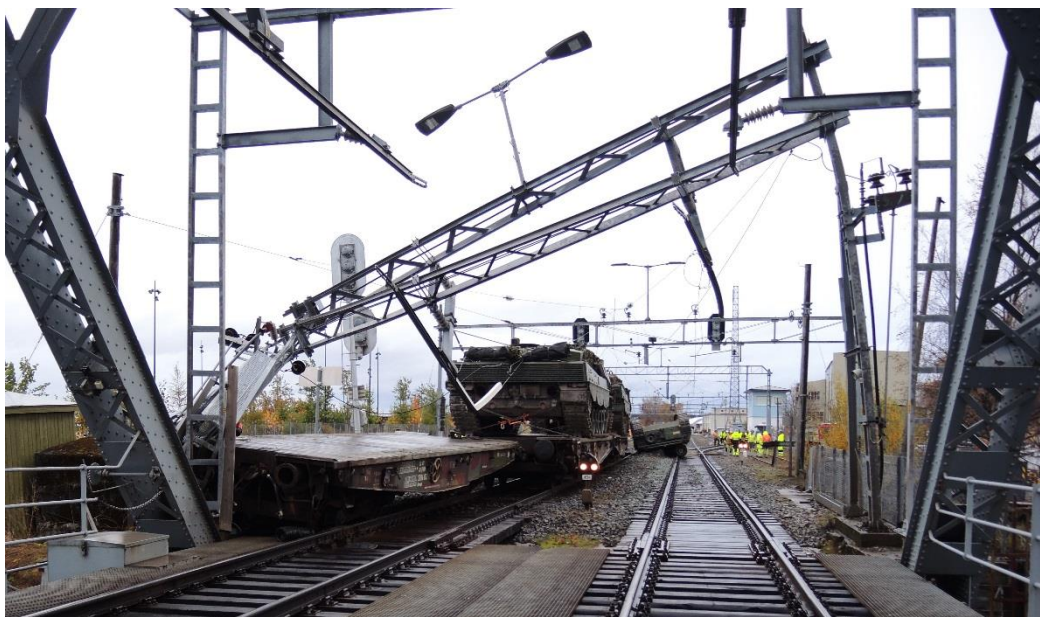
Figur 4: Skansen bru dagen etter avsporingen. Foto: SHT
