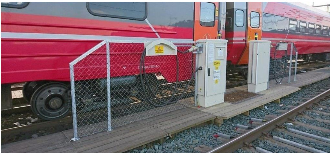
Figur 11: Varmepost mellom spor 13 og 14, toget på bildet har ikke noe med hendelsen å gjøre. Foto: Bane NOR
