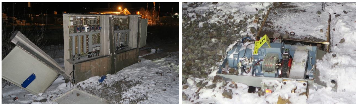
Figur 10: Skade på signalskap og drivmaskin. Foto: SHT
