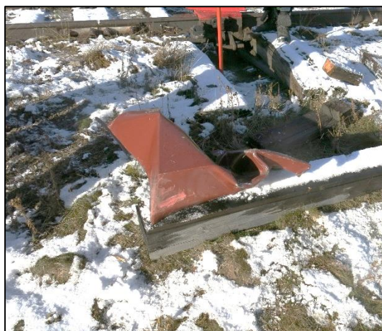
Figur 6: Deformert snødeksel. Foto: SHT
