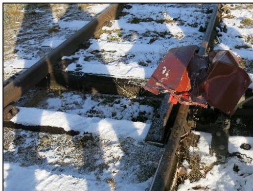
Figur 5: Deformert snødeksel. Foto: SHT
