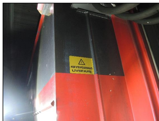
Figur 16: Skilting høyspenning livsfare. Foto: SHT
