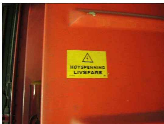
Figur 15: Skilting høyspenning livsfare. Foto: SHT
