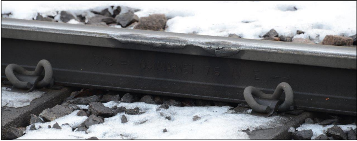
Figur 11: Slitasje på skinneprofil. Foto: SHT
