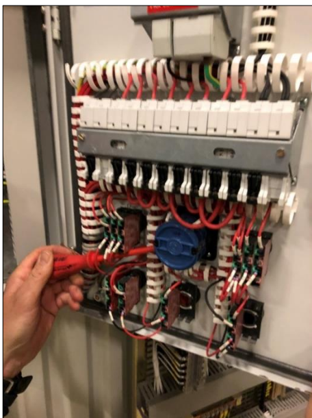
Figur 38: Kontroll av løse ledninger. Foto: SHK
