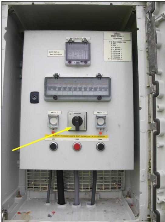
Figur 21: Fremtiden av betjeningsskapet med aktuell bryter markert. Foto: SHK
