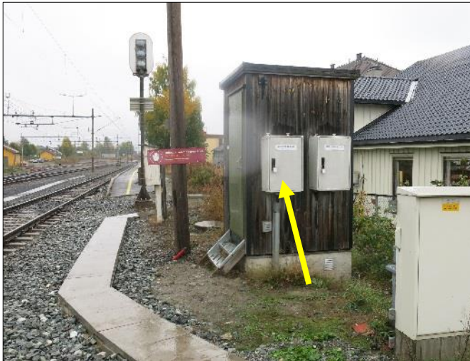
Figur 18: Kiosk med betjeningskap (markert) og utstyrskap til Vikersund planovergang 1. Foto: SHK
