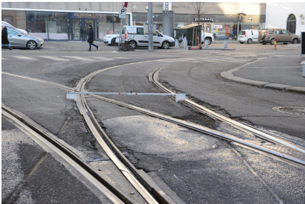
Figur 18: Inntrykk av spor og asfalt. Foto: SHK
