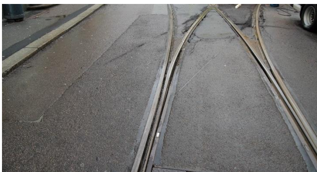
Figur 5: Merker i asfalten etter avsporingen. Foto: SHK
