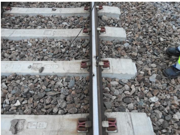
Figur 13: Røket bæreline og svimerker. Foto: SHK
