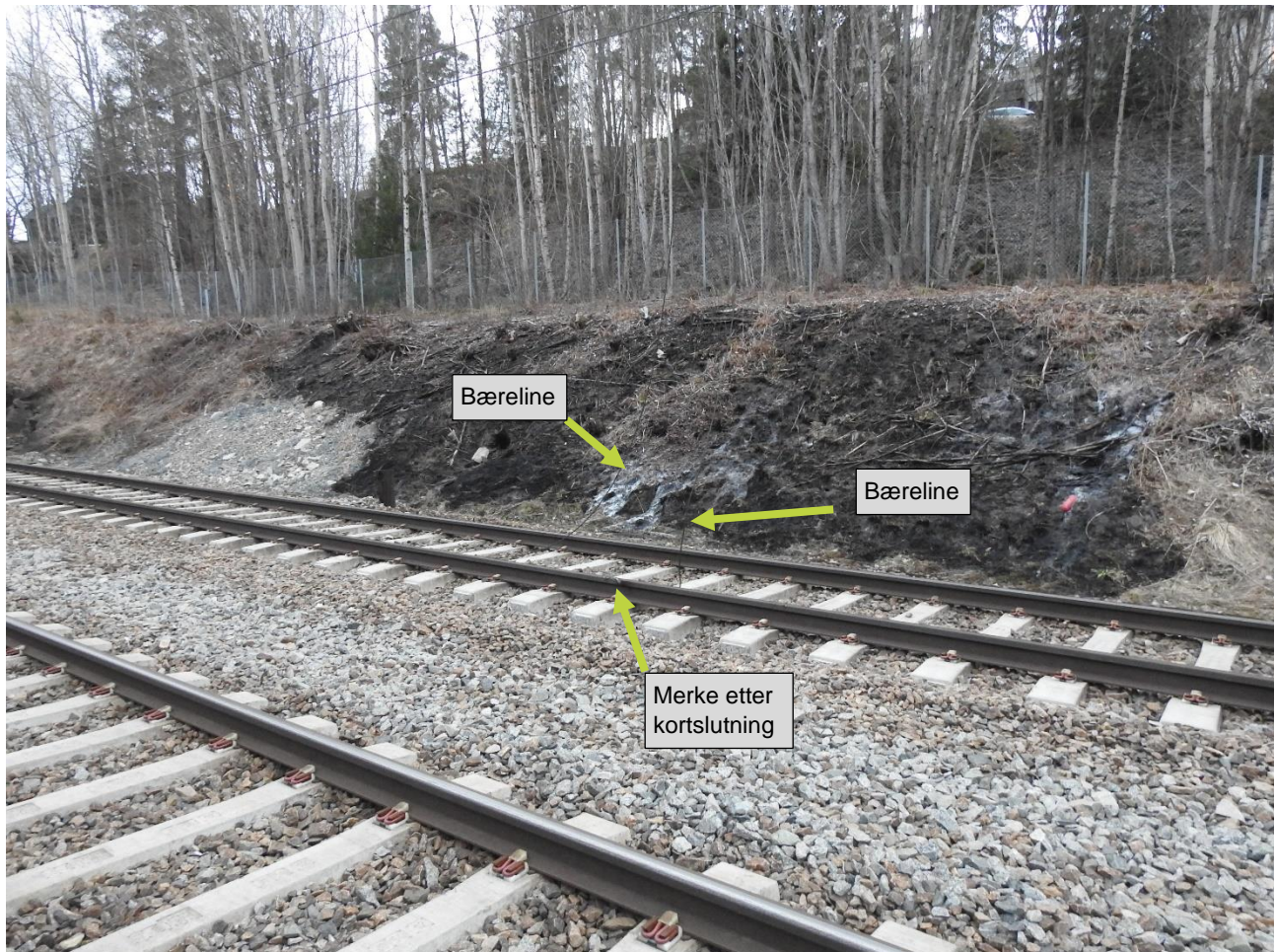
Figur 10: Brannsted ved km 11,923. Foto: SHK
