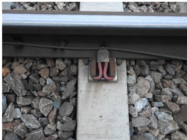
Figur 14: Flere merker etter kortslutning. Foto: SHK
