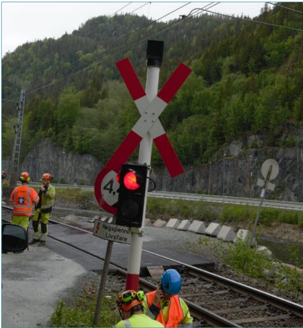
Figur 23: Rød lampe i veisignal V1 lyste da bilbatteri ble tilkoblet. Foto: SHK
