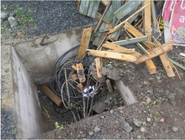
Figur 3: Signalkiosken ble revet av fundamentet i sammenstøtet. Foto: SHK
