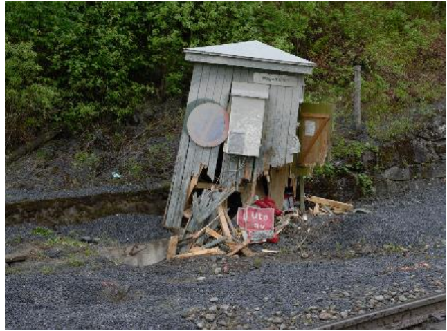
Figur 4: Sterkt skadet signalkiosk etter at den ble truffet av traktorens tilhenger. Foto: SHK
