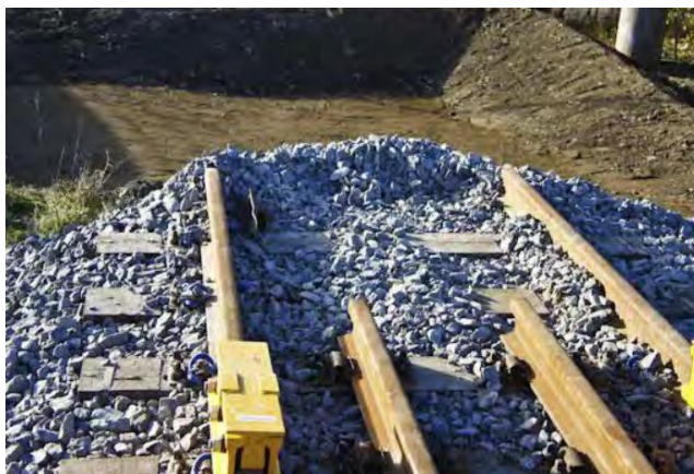
Figur 15: Avledende sporveksel 30 på Alnabruterminalen med sandbasseng. Foto: Bane NOR
