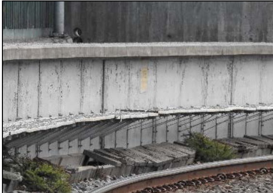
Figur 18: Nedfallssikring i kurven på Holstein T-banestasjon. Foto: SHT
