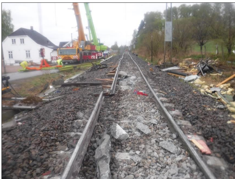
Figur 6: Skadet infrastruktur. Foto: Vy Berging og beredskap Jernbane AS
