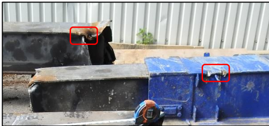
Figur 27: Merker etter togets hjul på høyre rammevange. Foto: SHK
