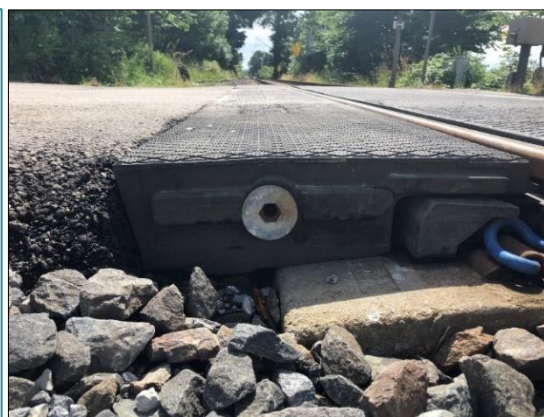
Figur 53: Strailelement sett fra enden mot togets retning 29. juni 2020. Foto: SHK
