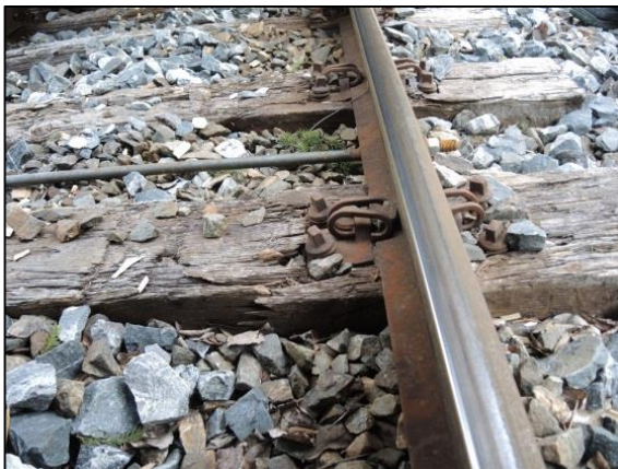
Figur 14: Strekkbolter og lite puk. Foto: SHT
