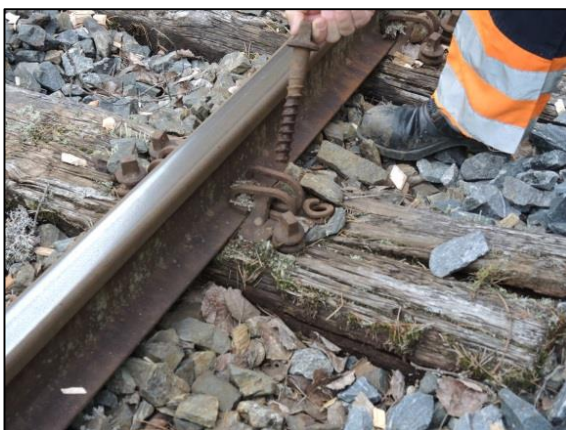
Figur 18: Manglende feste for svilleskrue. Foto: SHT
