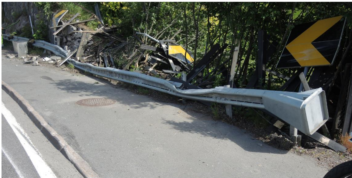
Figur 9: Skader på rekkverk, skilt og skjerming på høyre side av veien der lastebilen kjørte ut av veien. Foto: SHT
