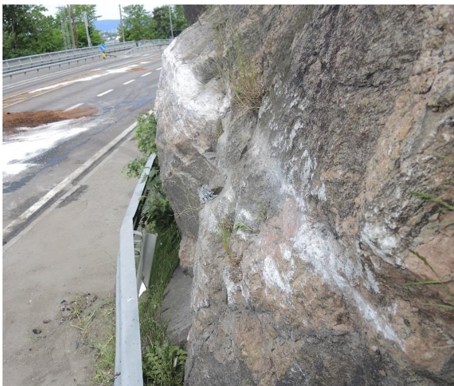
Figur 6: Fjellskjæringen som lastebilen traff da den kjørte utfor veien. Foto: SHT
