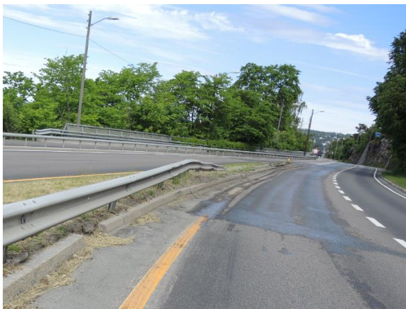
Figur 4: Bildet er tatt i lastebilens kjøretning. Midt i bildet vises skadene på rekkverket i midtrabatten som lastebilen traff først. Foto: SHT
