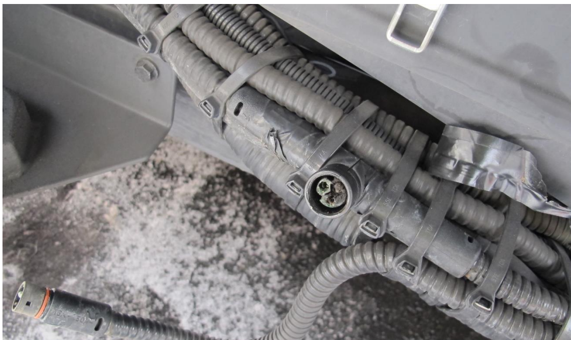
Figur 14: Demontert skjøteledd (T-stykke), med skader og irr, i referansebussens front, montert uskjermet fra veimiljøet og i parallelle slynger.
