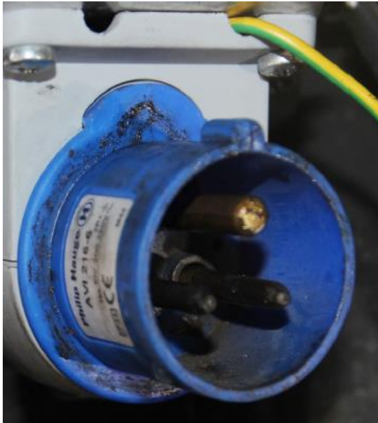
Figur 9: 309-støpselet i referansebussen med smørefett, spor etter varmgang og lysbueskader. Kontakten brukes ca. to ganger daglig for å koble eksternt strøm til bussen. Foto: Politiet
