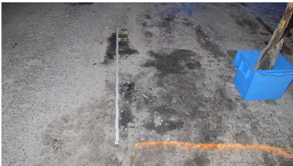
Figur 10: Fjernet smeltet nedfall fra vegbanen. Foto: SHT
