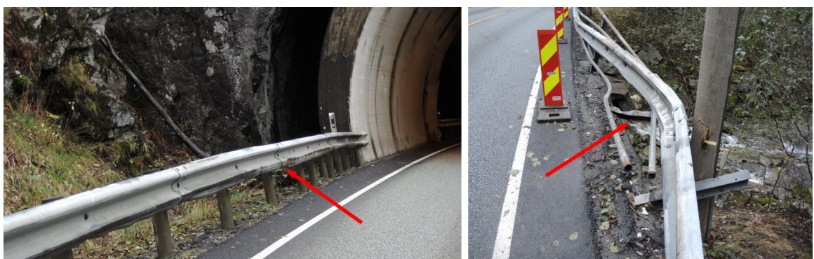
Figur 9: Skrapemerkene på siderekkerket i østgående kjørefelt og skader på brorekkerket. Foto: SHT
