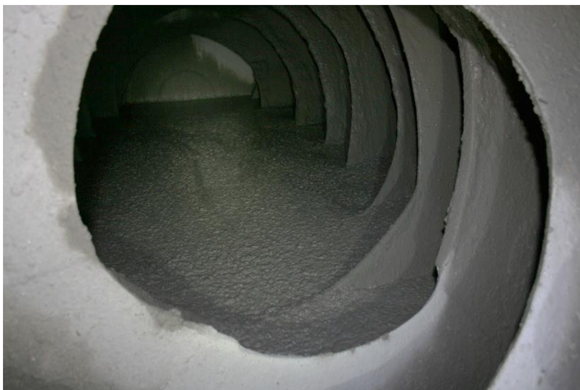
Figur 8: Bildet viser hvordan det så ut i betongtrommelen kort tid etter ulykken. Foto: Statens vegvesen
