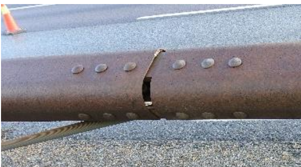
Figur 13: Boltet skjøt i midtrekkverket. Foto: SHK
