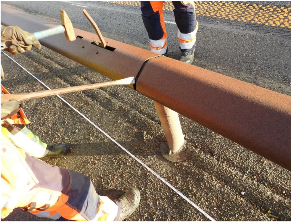
Figur 28: Funksjonsprøving av en nød-driftsåpningsskjøt med bruk av slegge og spett. Foto: SHK
