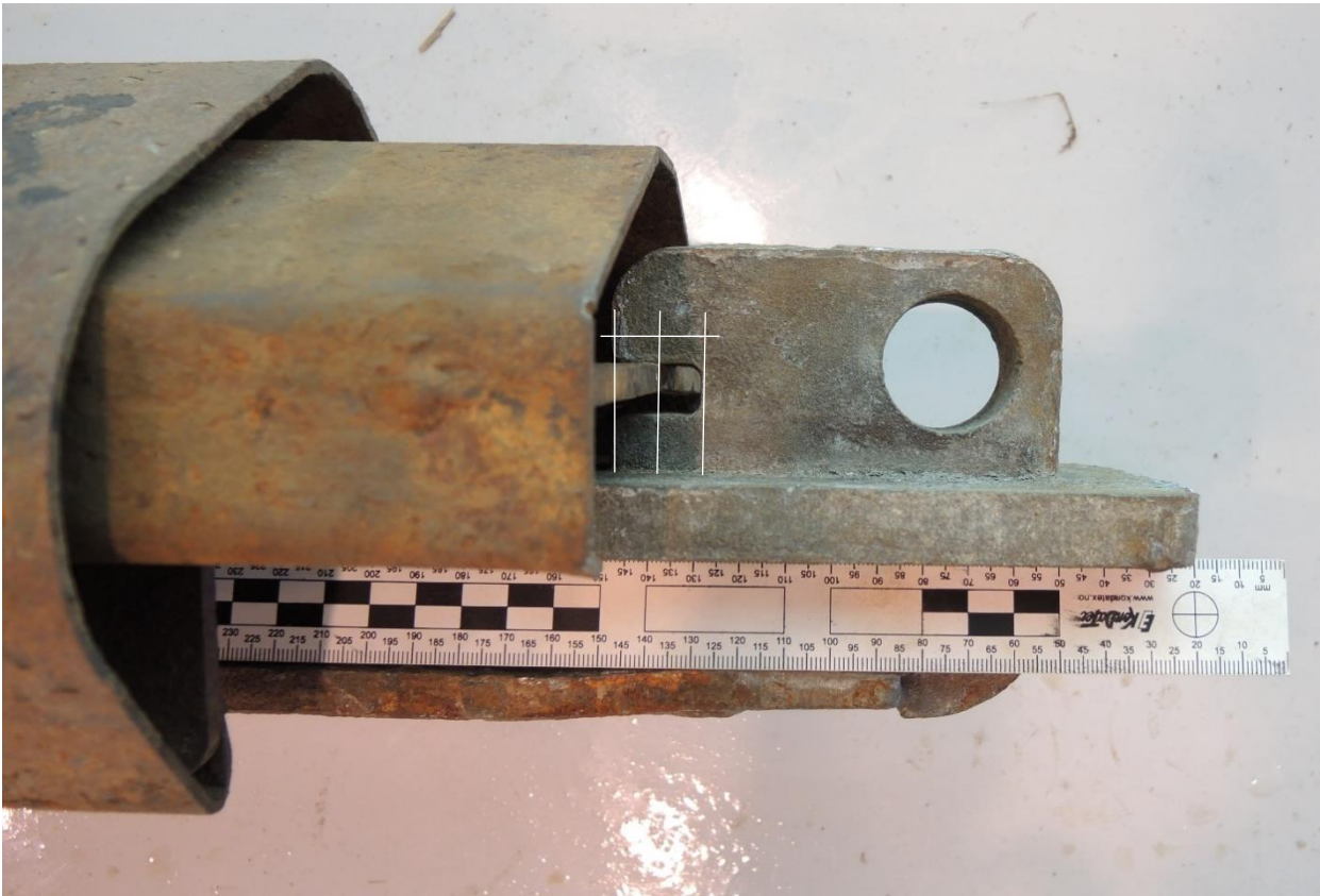
Figur 47: Når låsehåndtaket var i lukket posisjon og bolten deformert, gikk glideplaten bare halvveis i inngrep på låseklossen. Foto og illustrasjon: SHK
