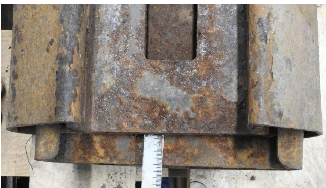
Figur 34: Glideplaten er ca. 2 cm utenfor egen rekkverksende på lås nr. 5. Foto: SHK
