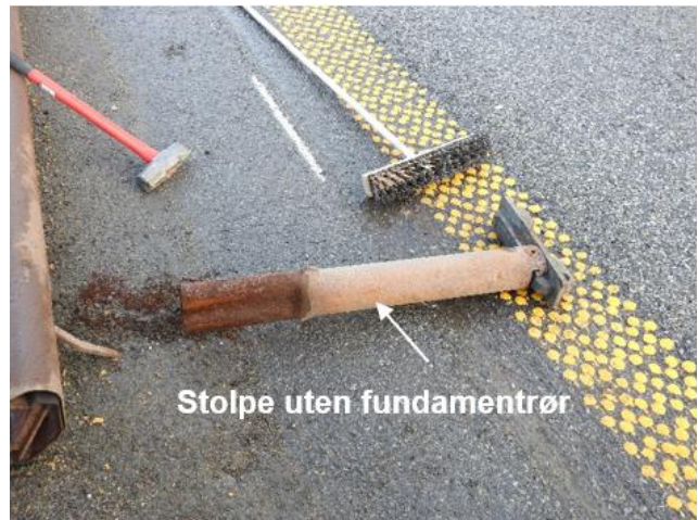
Figur 30: Stolpe uten fundamentrør med korrosjonsprodukter liggende igjen på bakken. Foto: SHK
