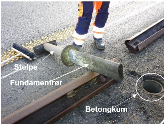
Figur 29: Stolpe med fundamentrør og betongsylinder. Foto og illustrasjon: SHK
