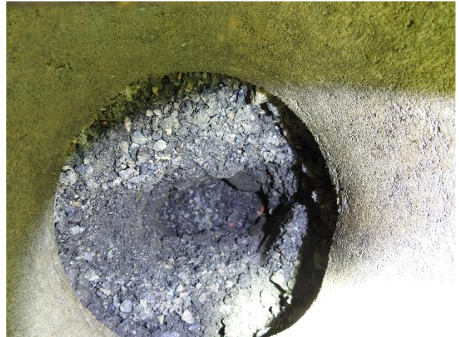
Figur 51: Innside av en betongsylinder som stolpene med fundamentrør satt i uten mothold. Se også oversiktsbilde av en betongsylinder i figur 29. Foto: SHK
