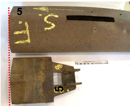
Figur 41: Glideplaten inndratt i egen rekkverksdel når skjøten er åpen. Foto og illustrasjon: SHK
