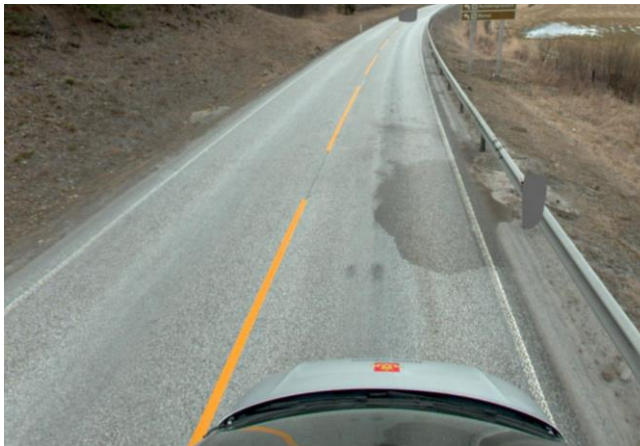
Figur 34: Dekkavsetning sett i sørgående kjørefelt i forkant av stedet ved sluttposisjonen til distribusjonsbilens drivhjul. Foto: Vegkart.no
