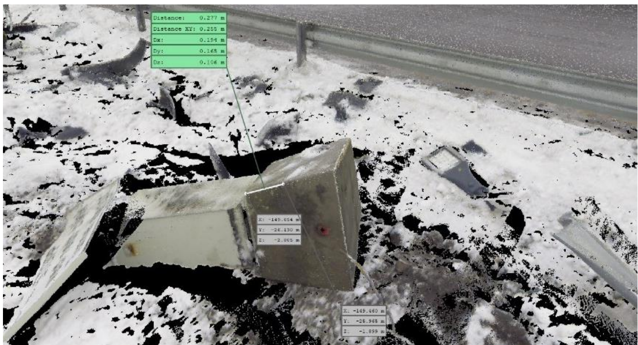
Figur 18: Betongfundamentet stakk ca. 28 cm over bakken. Området for målingen er markert med hvit linje på betongelementet Scan: Politiet. Mål: SHK
