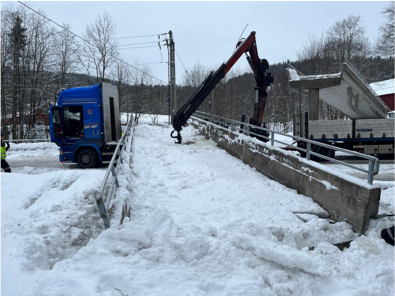
Figur 22: Bilete frå hendinga på E16, Sollihøgda, 3. februar 2023. Gangbrua kollapsa etter samanstøyten med kranarmen og landa ca. 40 cm frå førarhuset. Foto: Politiet
