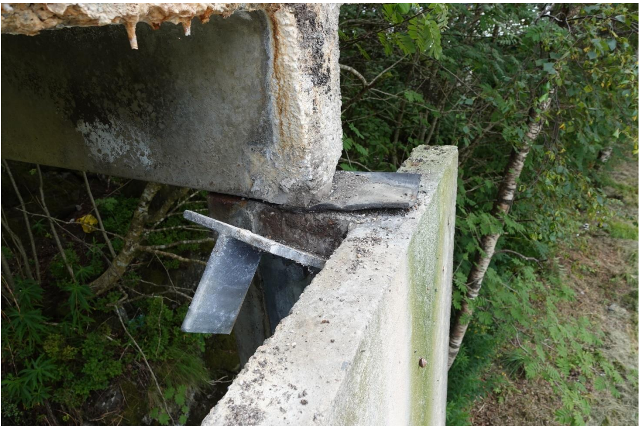
Figur 9: Del av gjenstående konstruksjon mot aust, der sidestyriinga er deformert. Foto: Rambøll
