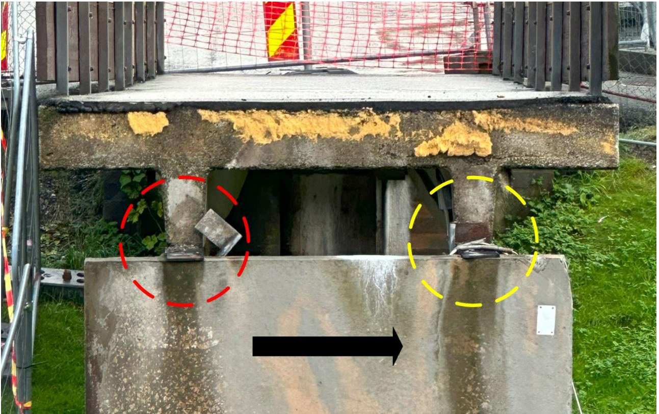
Figur 8: Gjenstående konstruksjon mot vest med ei deformert sidestyring (raud sirkel) og ei sidestyring intakt (gul sirkel). Den svarte pila viser køyreretninga til lastebilen og retninga som brua blei skoven av pilaren. Foto: SHK
