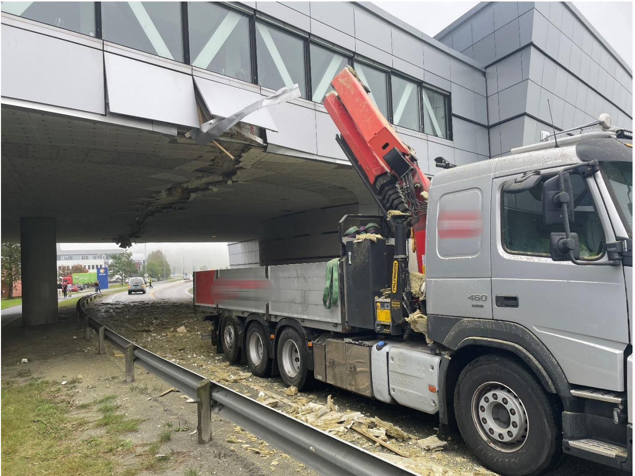
Figur 24: Bilete frå hendinga på rv. 80 i Bodø 21. august 2023, der ein lastebil med heva kranarm skadde delar av bygningsmassen til Norsk Luftfartsmuseum. Foto: Politiet
