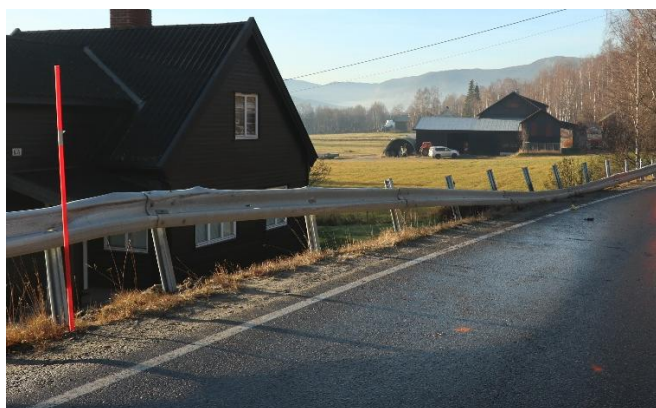
Figur 13: Nedrevet rekkverk. Foto: SHK
