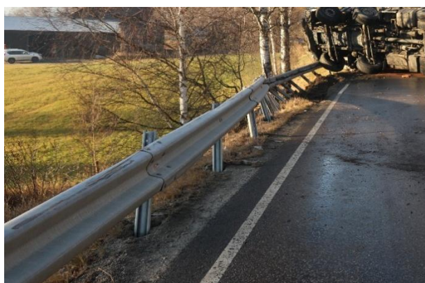
Figur 14: Utpresset rekkverk. Foto: SHK
