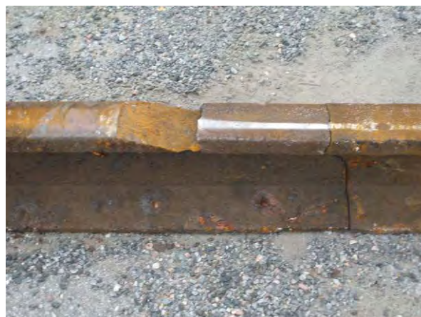
Figur 2: Skinnebruddet etter at en løs del er lagt på plass. Den manglende biten ble ikke funnet. (Foto: JBV).
