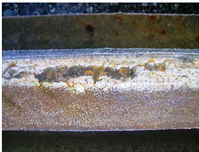
Figur 5: Avskalling på kjørebanelen.
