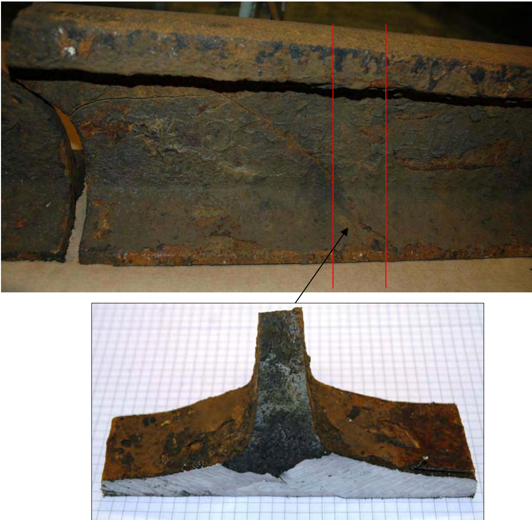
Figur 5 Bilde av utkapping av sprekkfronten.
