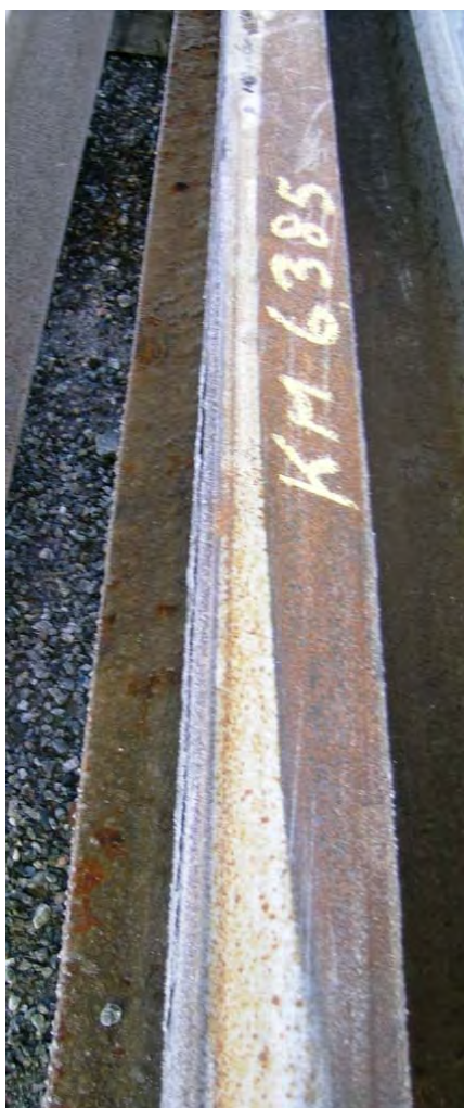
Figur 3: Skinne med tydelig korrosjonsskade på kjørebanelen.
