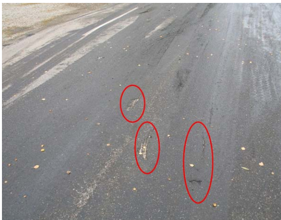
Figur 6: Ferske skrapespor i midten av veibanen ved krysset. (foto: Statens vegvesen)
