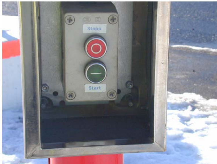
Bilde viser betjeningsboks for signalanlegget
