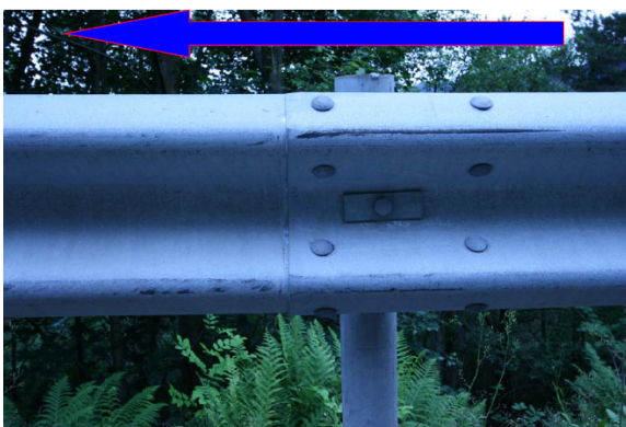
Figur 11: Lakkmerker i autovern, avskrapninger tyder på bevegelse i kjøreretning. (Foto: Statens vegvesen)
