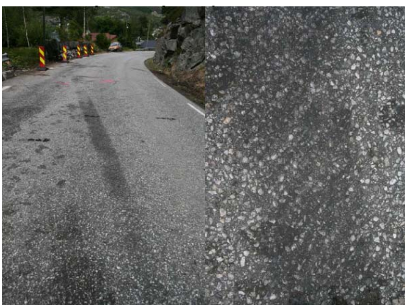
Figur 17: Fører fikk problemer med å rette opp lastebilens styring etter at hjulene ble slått ut i full sving til venstre og skrenser på asfalten. (Foto: Statens vegvesen)
