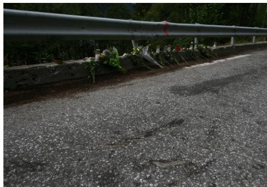
Figur 16: Avsetning i asfalt etter Toyota. (Foto: Statens vegvesen)
